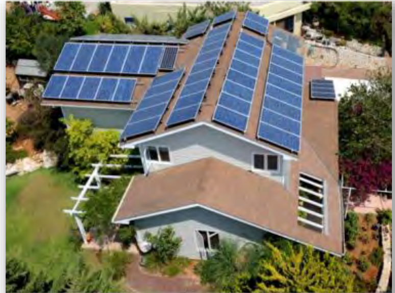
15kW installatie, 1 x 3-fase omvormer
