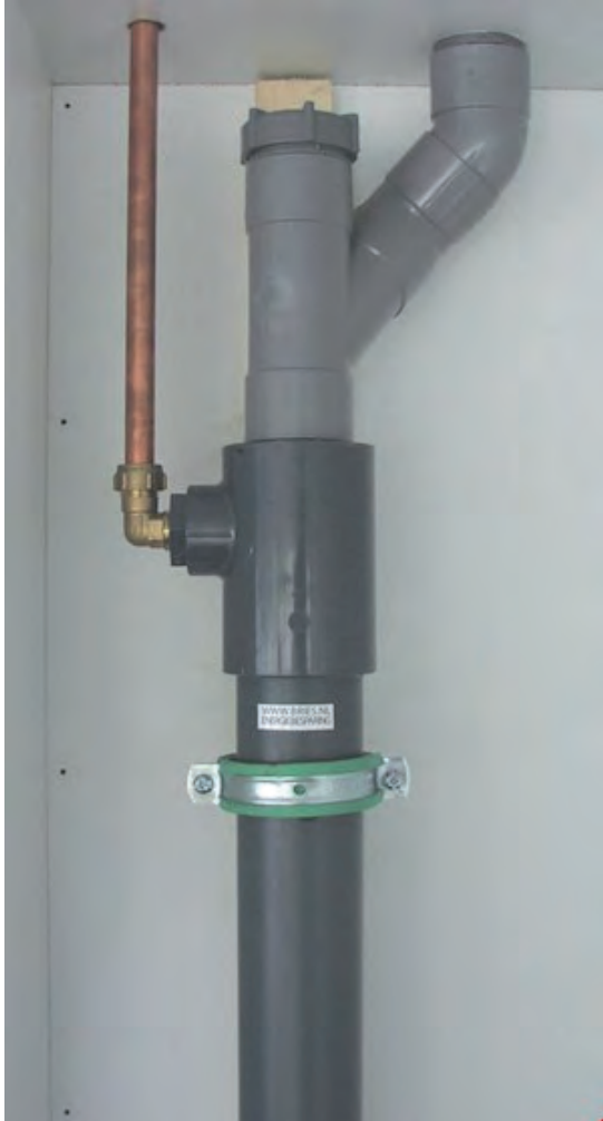
Afb. 5 Aansluiting opgewarmd water (links) en afvoer van douchebak (rechts)
