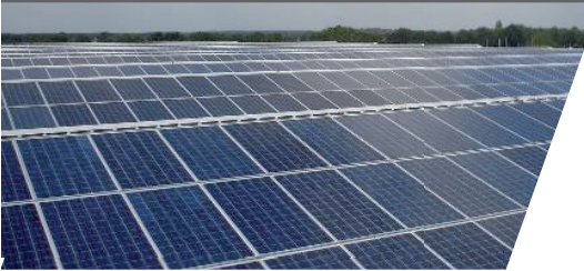
Venco Campus | 1,63MW
