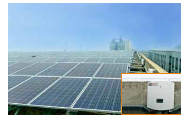
Changzhou Vaillant 2MW
