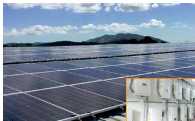
Panama UGE Cochez 3.4MW
